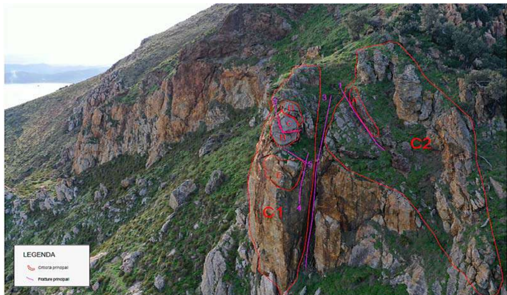
Figura 7 – Tavola 1 delle fratture e criticità principali rilevate in sito
