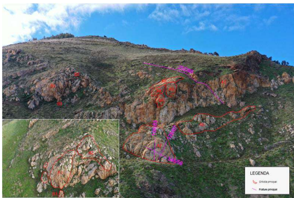
Figura 11 – Tavola 5 delle fratture e criticità principali rilevate in sito
