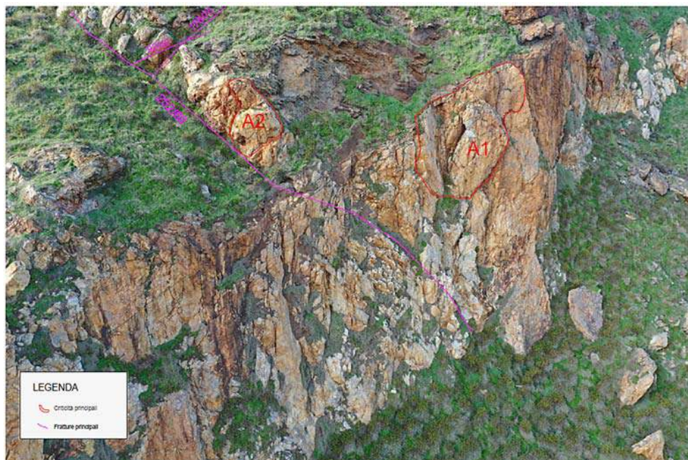
Figura 10 – Tavola 4 delle fratture e criticità principali rilevate in sito
